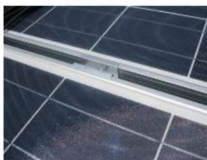
Milieu du champ PV entre modules
